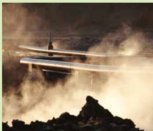
Рис. 3.1.13. Трубопровод геотермальной электростанции.
