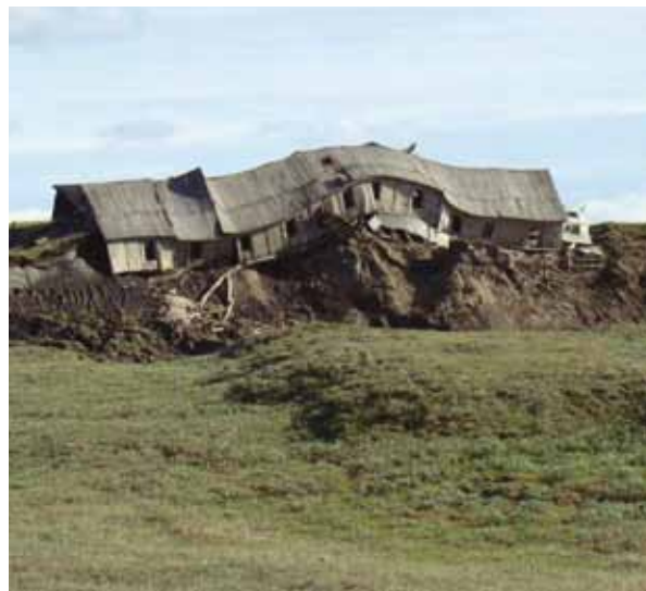
Рис. 2.8.9. Здание воинской части, разрушенное из-за неравномерного пучения и просадок.
