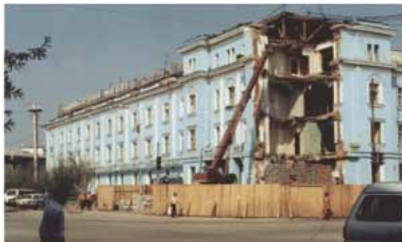
Рис. 2.8.11. Обрушение угла здания. Центр г. Якутск (Россия).
