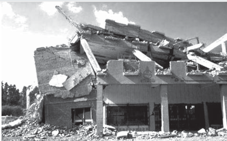
Пример последствий землетрясения силой в 6,2 магнитуды
