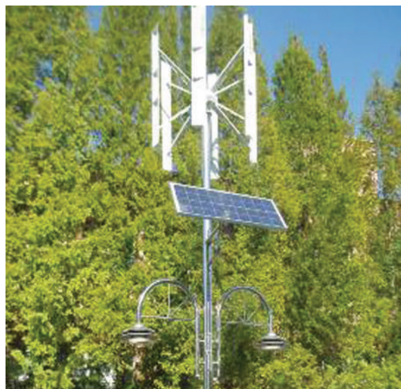
Гибридные ветро-солнечные электростанции мощностью до 300 Вт для освещения Тянь-Шаньского высокогорного научного центра Института ВПигЭ
