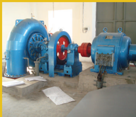
Турбина и генератор мощностью 250 кВт на МГЭС в с. Бала-Айылчы
