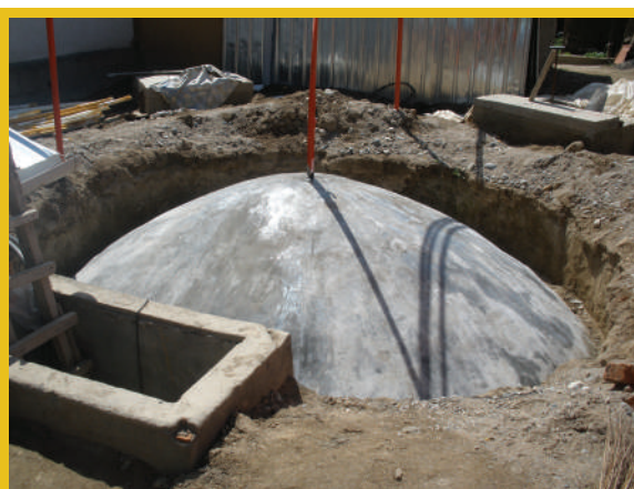
Камера для сырья биогазовой установки
