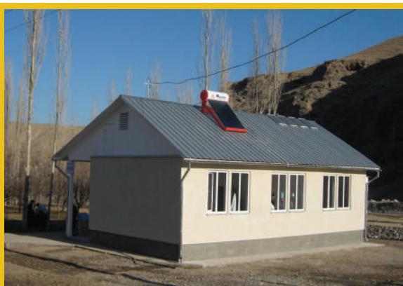
Солнечные коллекторы для горячего водоснабжения ФАП в с. Коммуна Баткенской обл.
