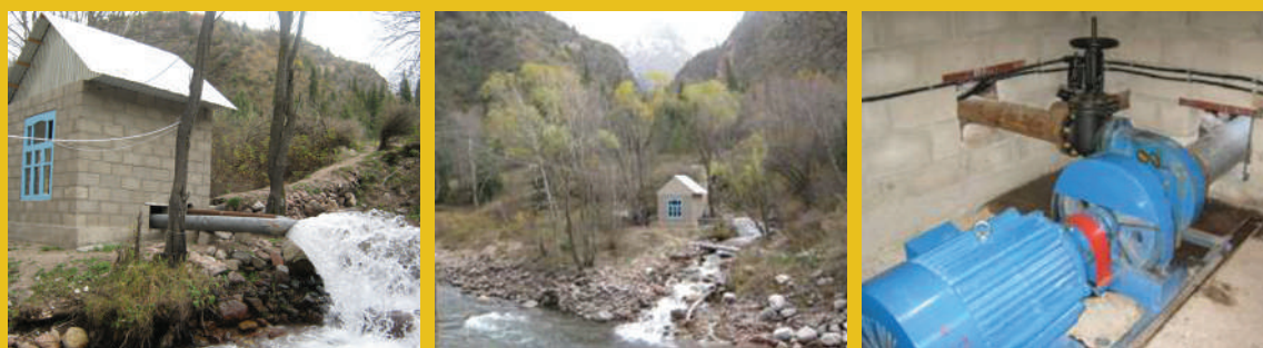
МикроГЭС мощностью 40 кВт в ущелье Чычкан на 241км автодороги Бишкек-Ош
