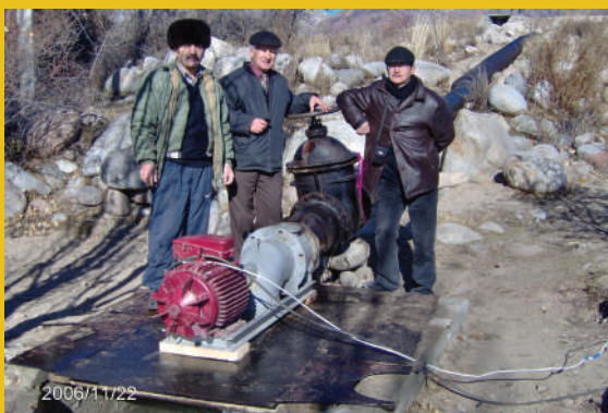
МикроГЭС мощностью 8 кВт с пропеллерной гидротурбиной
