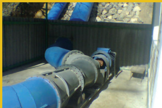
МикроГЭС мощностью 50 кВт с поворотнолопастной гидротурбиной
