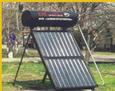
Солнечная водонагревательная установка
