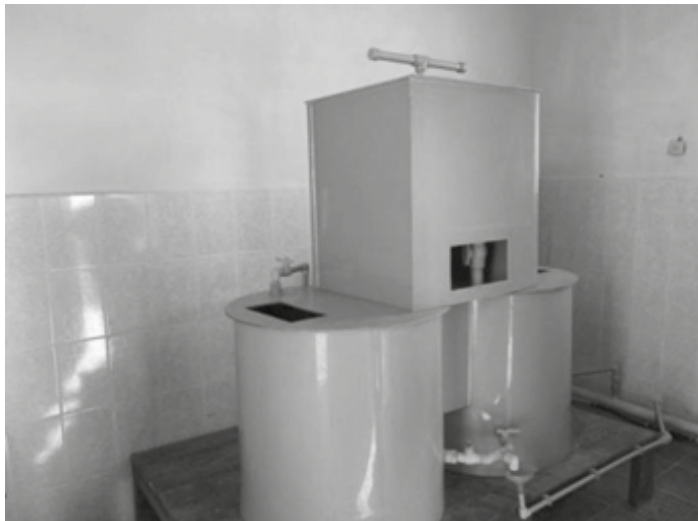
Фото АРИС: Существующая система подготовки и дозирования раствора \text{Ca}(\text{ClO})_2
