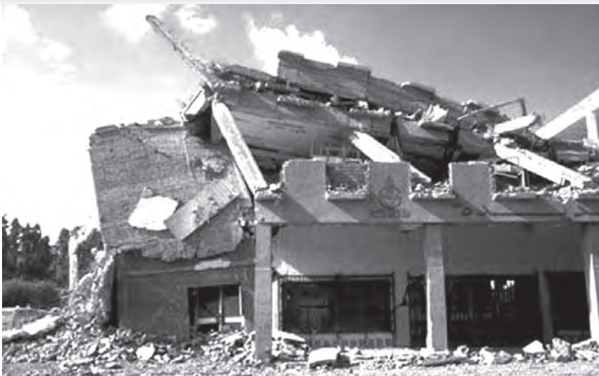
Пример последствий землетрясения силой в 6,2 магнитуды
