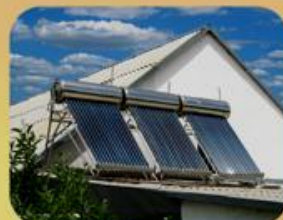
Коллектор для отопления, установленный в частном доме (г. Новоокровка, Чуйская область)
