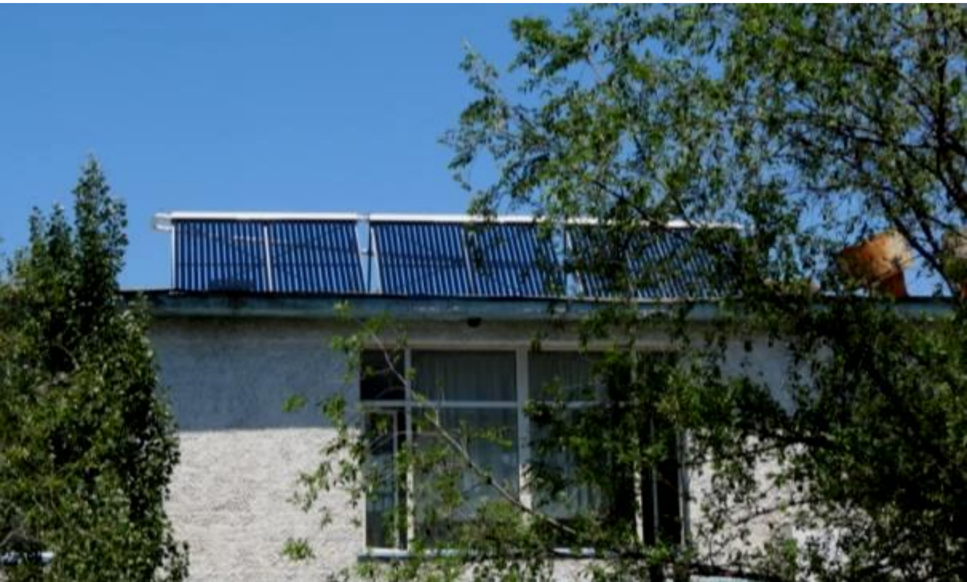
Вакуумные коллектора на здании детского дома г. Бишкек
